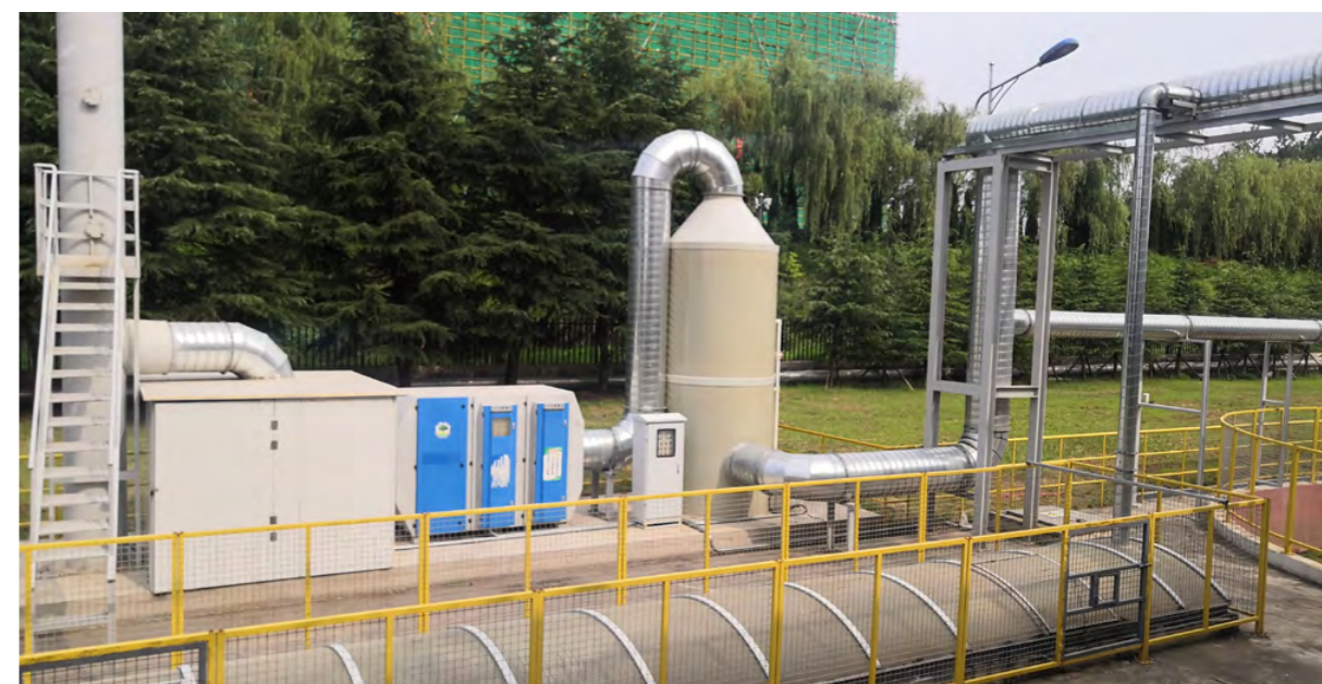
污水站臭气改善装置
