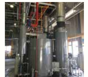
新换环保贯流式锅炉房
