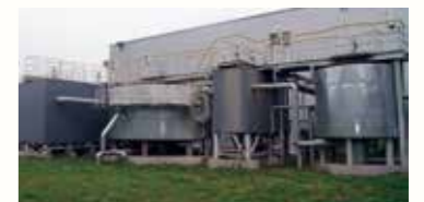
北京现代污水处理站
